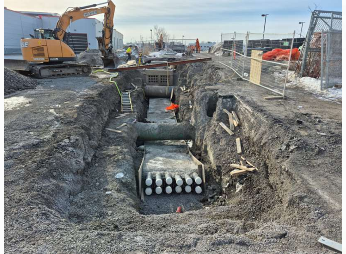
Distribution de l'énergie électrique
