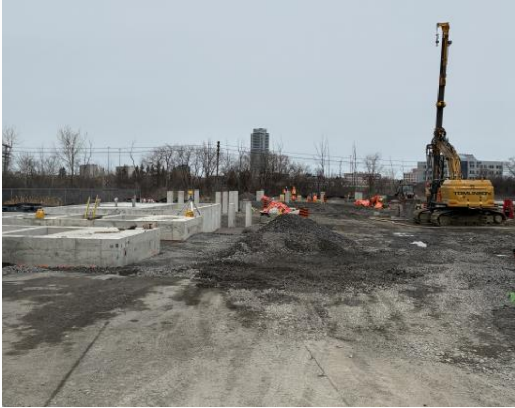
Fondation pour équipement électrique
