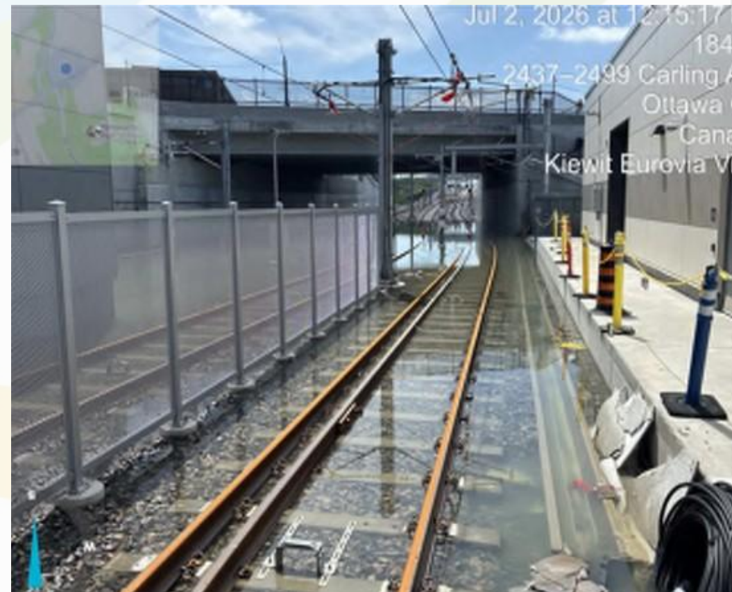
Inondation à la station Lincoln Fields
