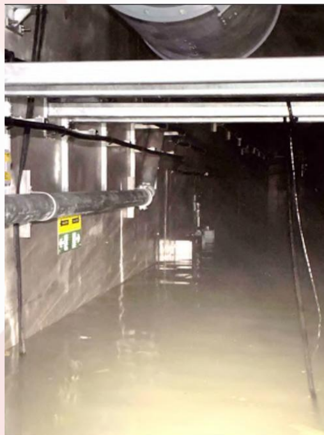
Inondation dans le tunnel à l'ouest de la station New Orchard
